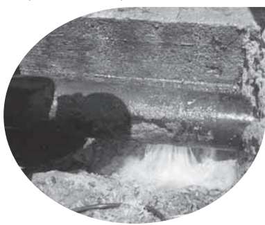
漏水している水道管
