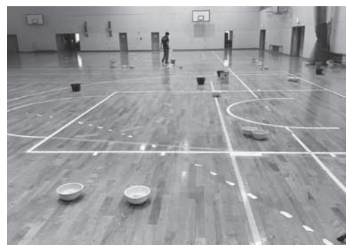
平成30年9月4日台風21号による河和中学校体育館の雨漏り状況
