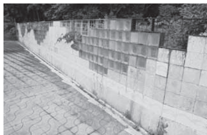
布土小学校プールのブロック塀 9月補正予算で撤去されます
