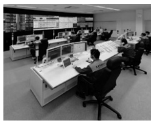
知多広域消防指令センター 指令室
