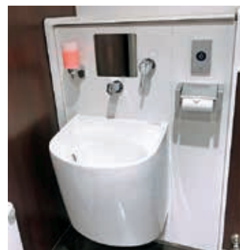
オストメイト設備
